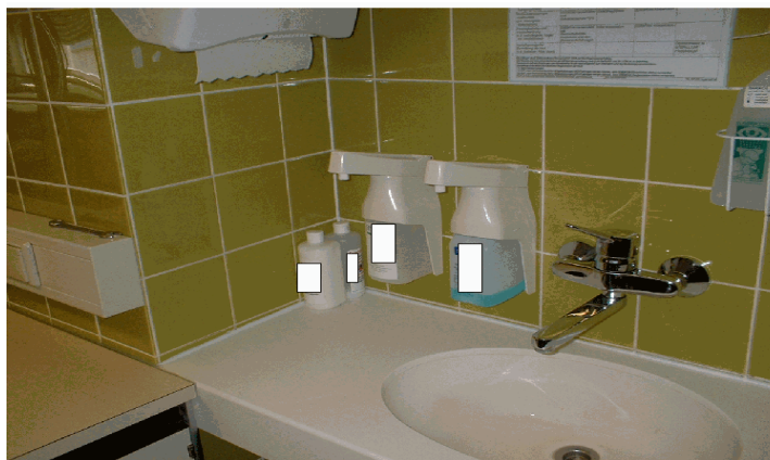
Beispiel eines Händewaschplatzes (Hinweis: Auswahl zufällig; auch vergleichbare Desinfektionsmittelspender und Einhebelarmaturen sind geeignet).
